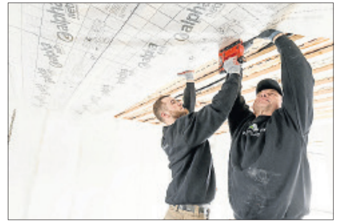
Betapack sælger sine dampspærreløsninger gennem byggemarkeder, og her er 90-95 pct. af de solgte dampspærre en PE-folie. (Foto: John Ehbrecht)
